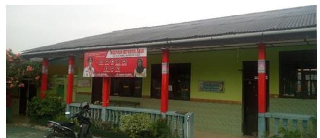
Gambar 9. Talang air terpasang
